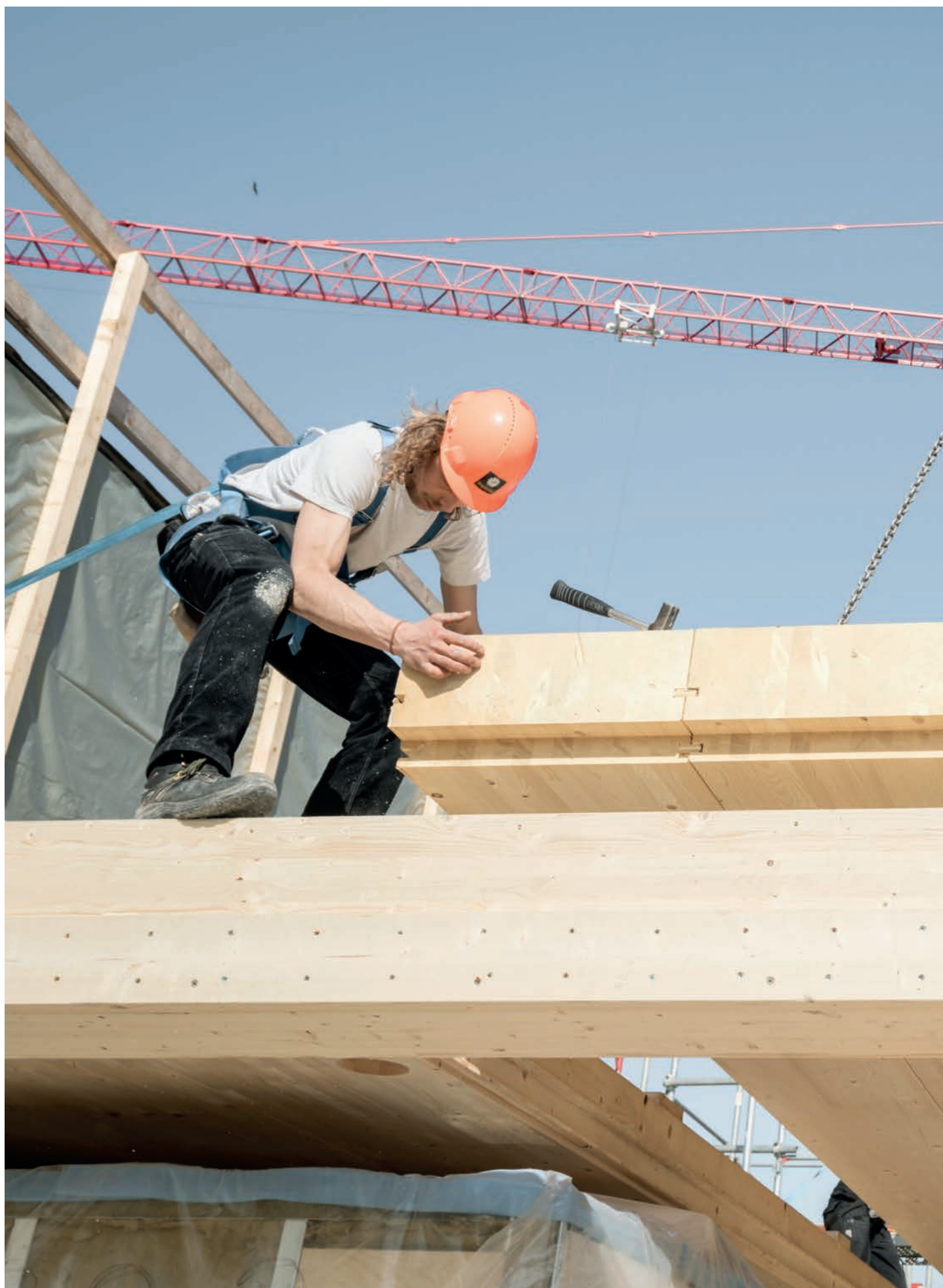
Geschoss um Geschoss: Nachdem die Stützen und Balken standen, setzten Holzbauer die Deckenelemente aus Brettschichtholz ein.
