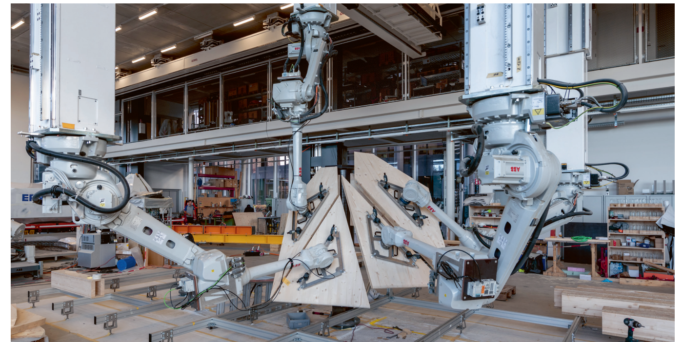
Tanz der Roboter. Der Zusammenbau folgt einer ausgeklügelten Choreografie. Vier Roboterarme positionieren zeitgleich vier Bauteile.
