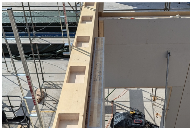
poches fraisées destinées à recevoir les cames de cisaillement de la poutre de Vierendeel
