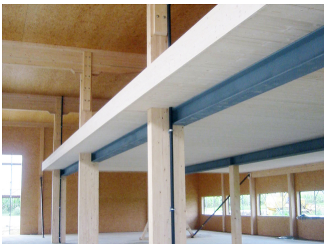
Galerie avec charge utile de 1t par m 2
