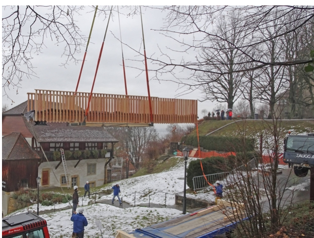
Une grue a soulevé le pont de 10,5 mètres de long jusqu'au bon endroit
