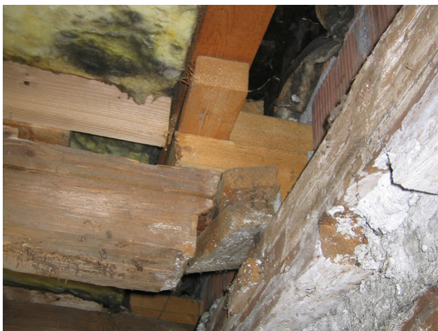
Support de poutres OG avant la rénovation
